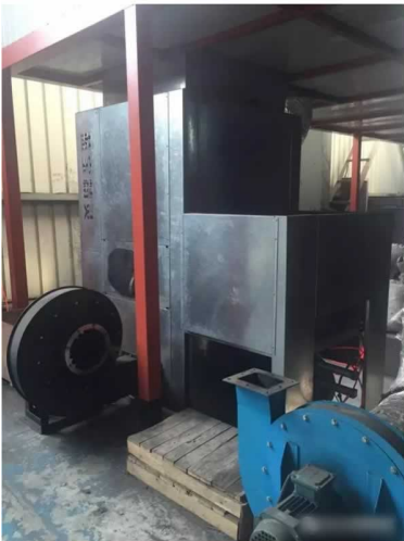
(热风锅炉案例)
