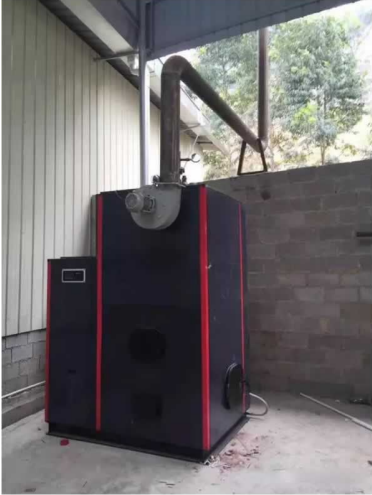
(热水锅炉案例)
