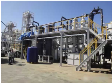
韩国400KW发电设备
