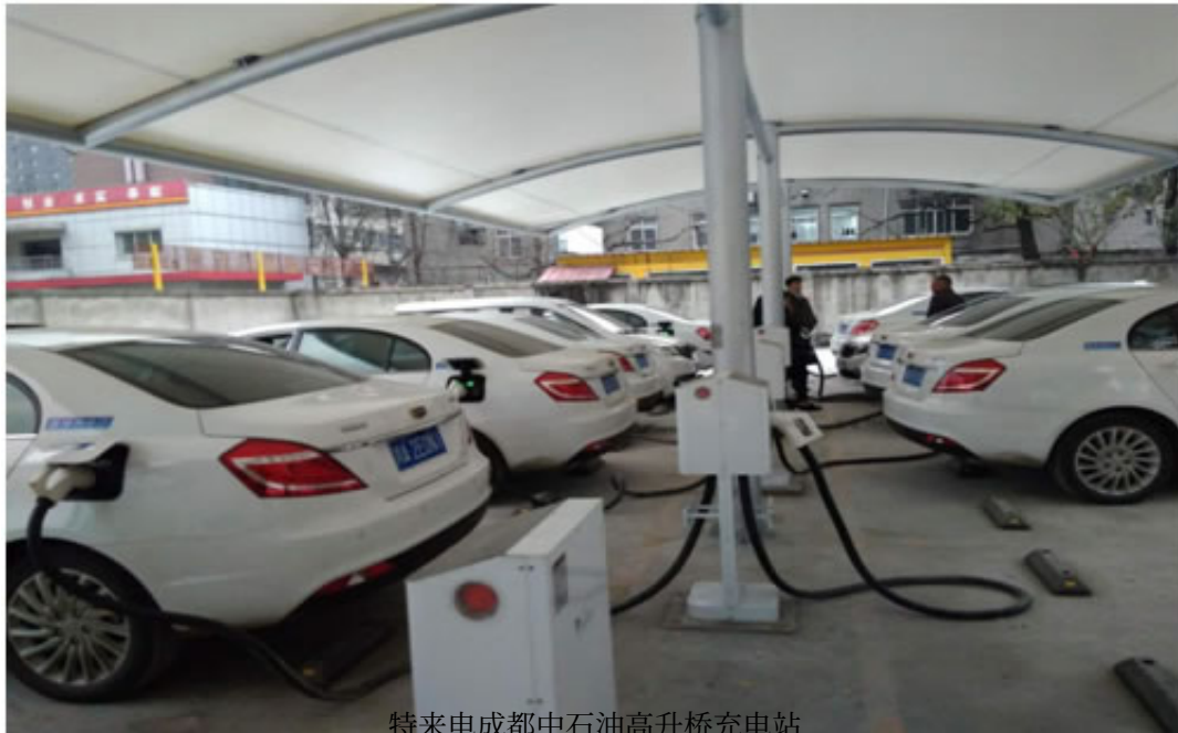
特来电成都中石油高升桥充电站
