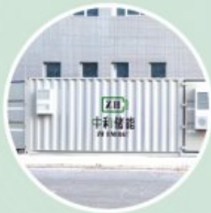
125kW全钒液流电池储能系统
