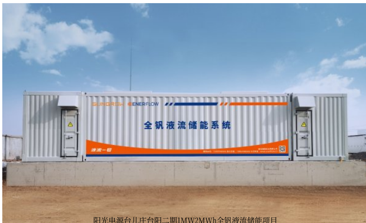
山东海化1MW4MWh盐酸基全钒液流电池储能电站
