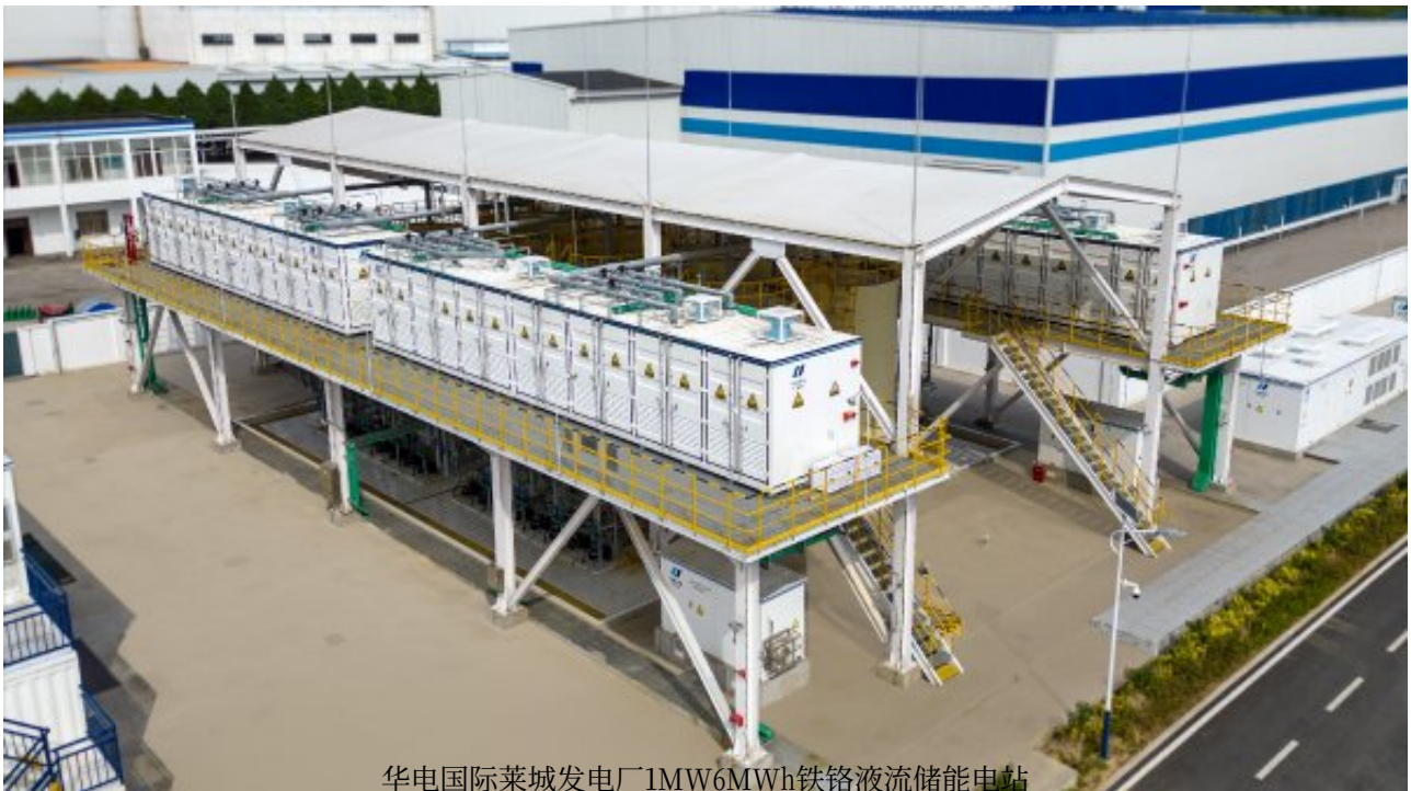
国家电投诸城1MW6MWh液流储能示范项目
