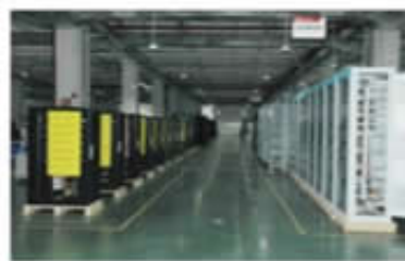
大数据中心(电源)总装车间
