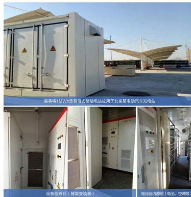
储能电站应用案例2现场照片
