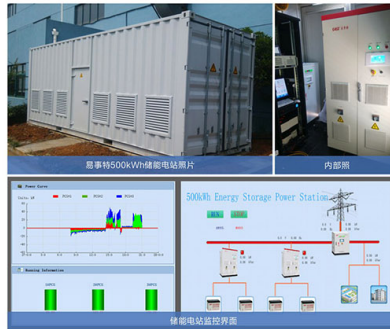
储能电站应用案例1现场照片
