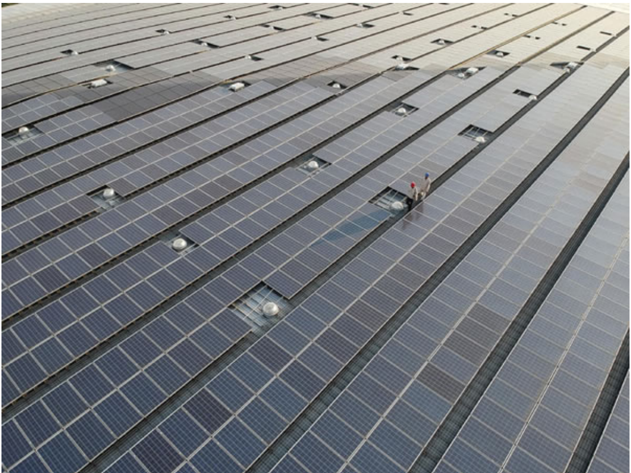
7月22日，国网靖江市供电公司工作人员在靖江市体育中心屋顶光伏电站巡检。
