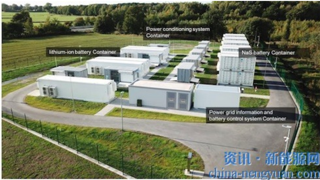
日立混合动力储能系统。图片：日立。
