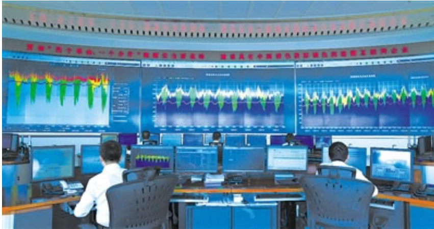
国网青海省电力公司调控中心人员在监控绿电实时成分。王国栋 摄
