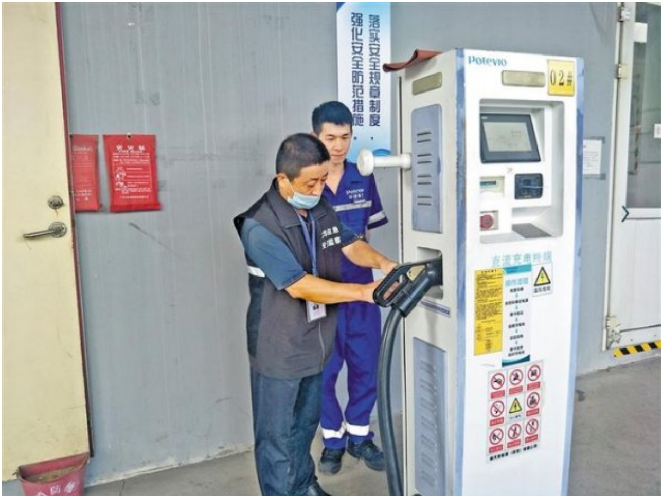
区安委办督导组在新能源车辆充电停车场检查充电桩。
