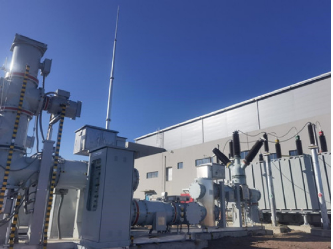
百兆瓦压缩空气储能系统升压站
