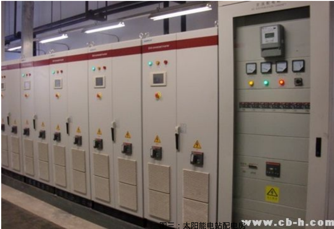
图三：太阳能电站配电房
