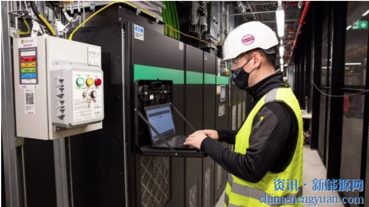
在都柏林数据中心现场测试UPS。图片：微软
