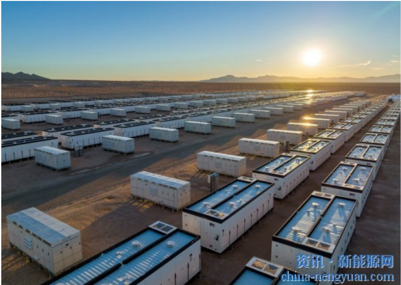
位于加利福尼亚州的Crimson Energy Storage，容量为1400MWh，是2022年美国上线的最大单站点BESS项目。图片：Recurrent Energy
