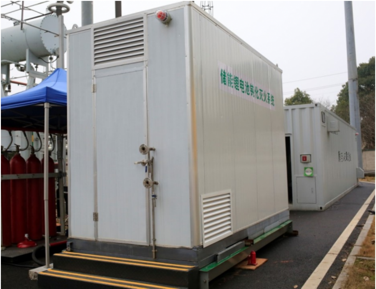
储能电池火灾防复燃灭火试验平台
