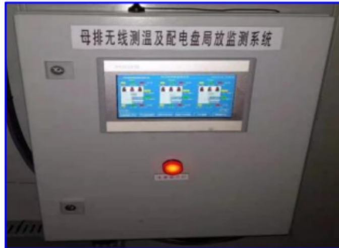
图 6 母排无线测温及配电盘局部放电监测控制箱
