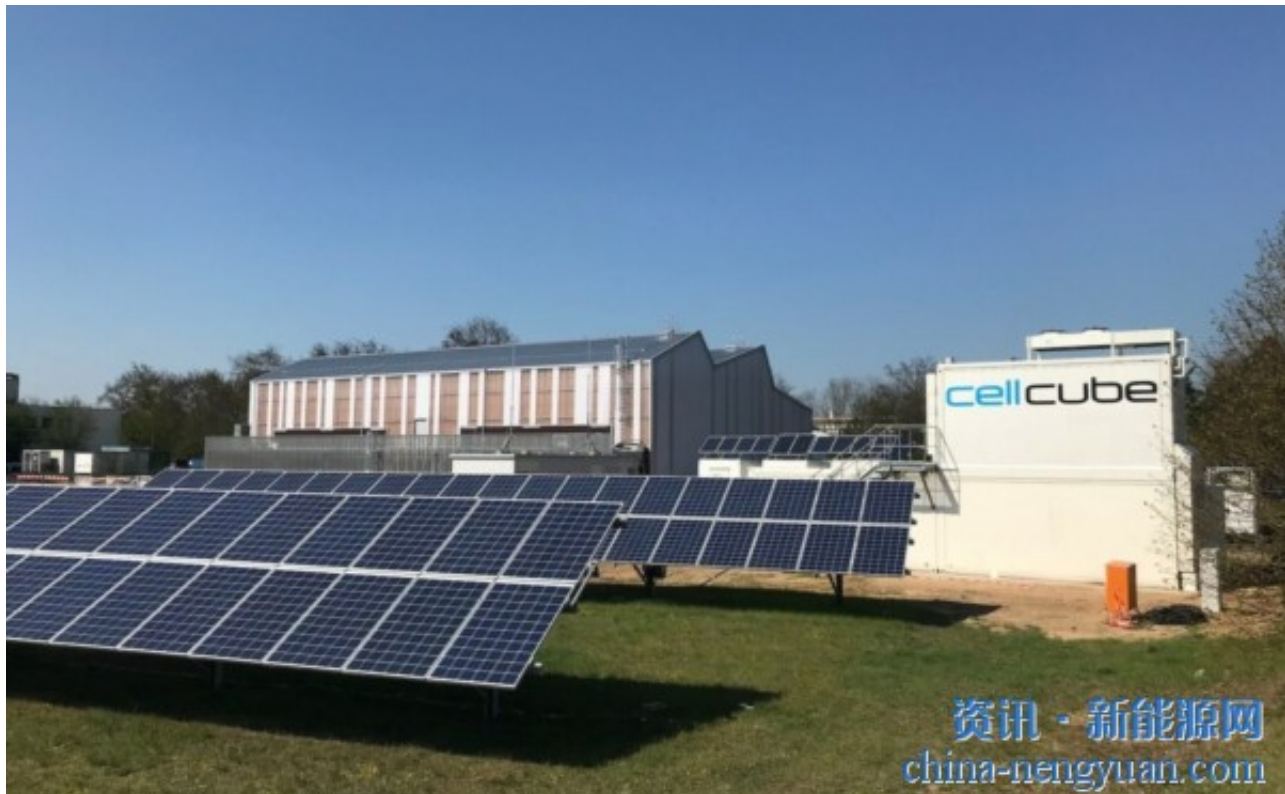
一个太阳能光伏阵列与一个共址CellCube VRFB系统。图片：CellCube/Enerox
