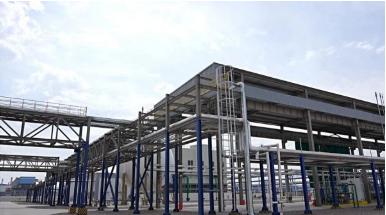
永利绿氢智慧综合能源加氢站
