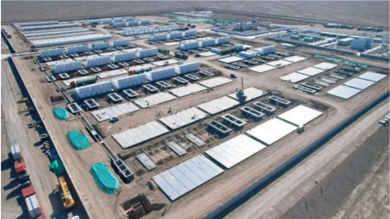
星辰新能交付 75MW/300MWh 全钒液流储能设备
