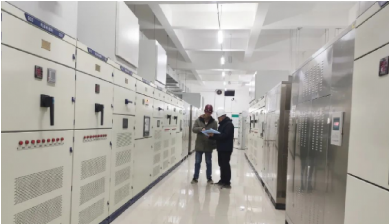
工作人员在配电室核对供电设备信息。
