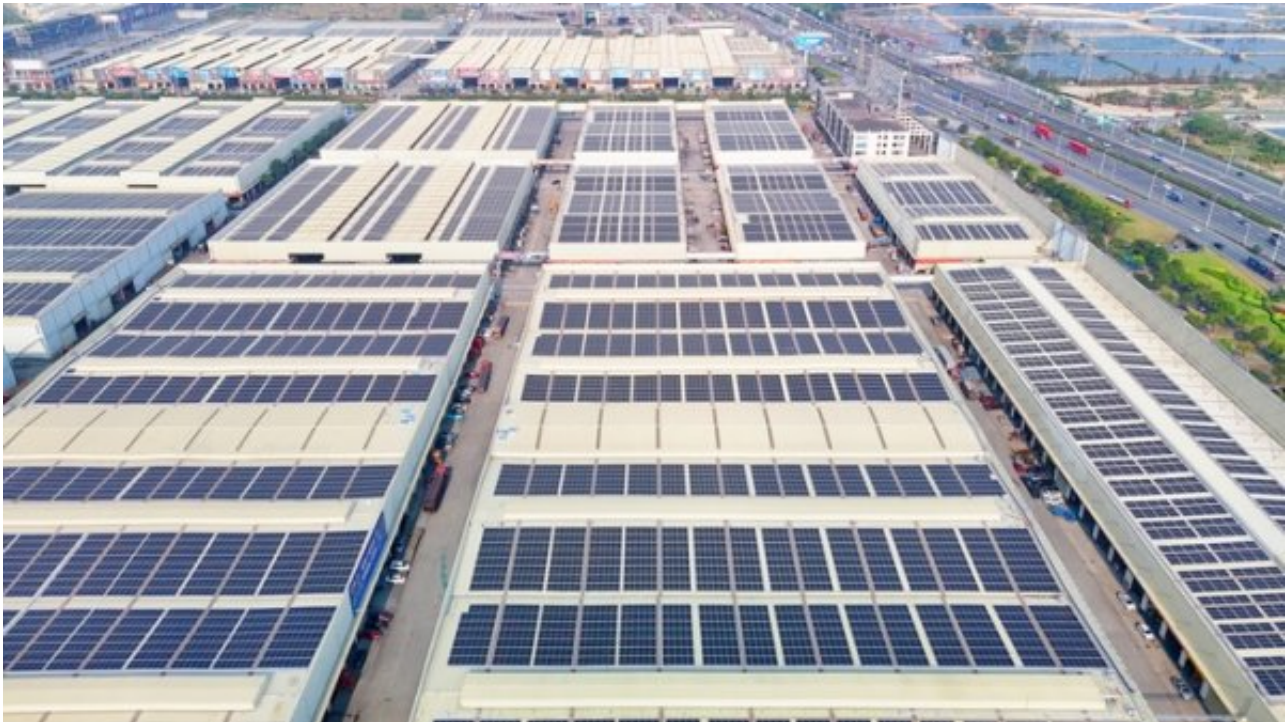
佛山乐从钢铁世界不锈钢A区光伏发电项目现场
