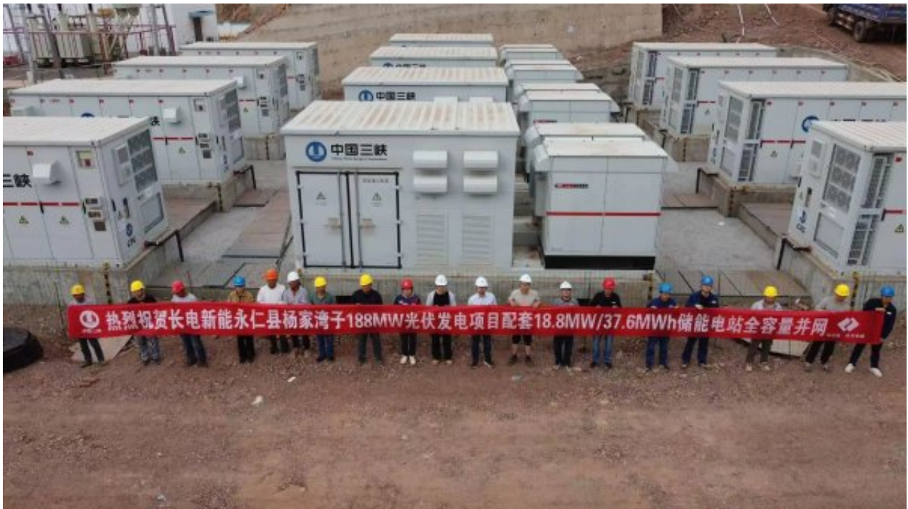
▲ 杨家湾子光伏项目配套储能系统全容量并网
