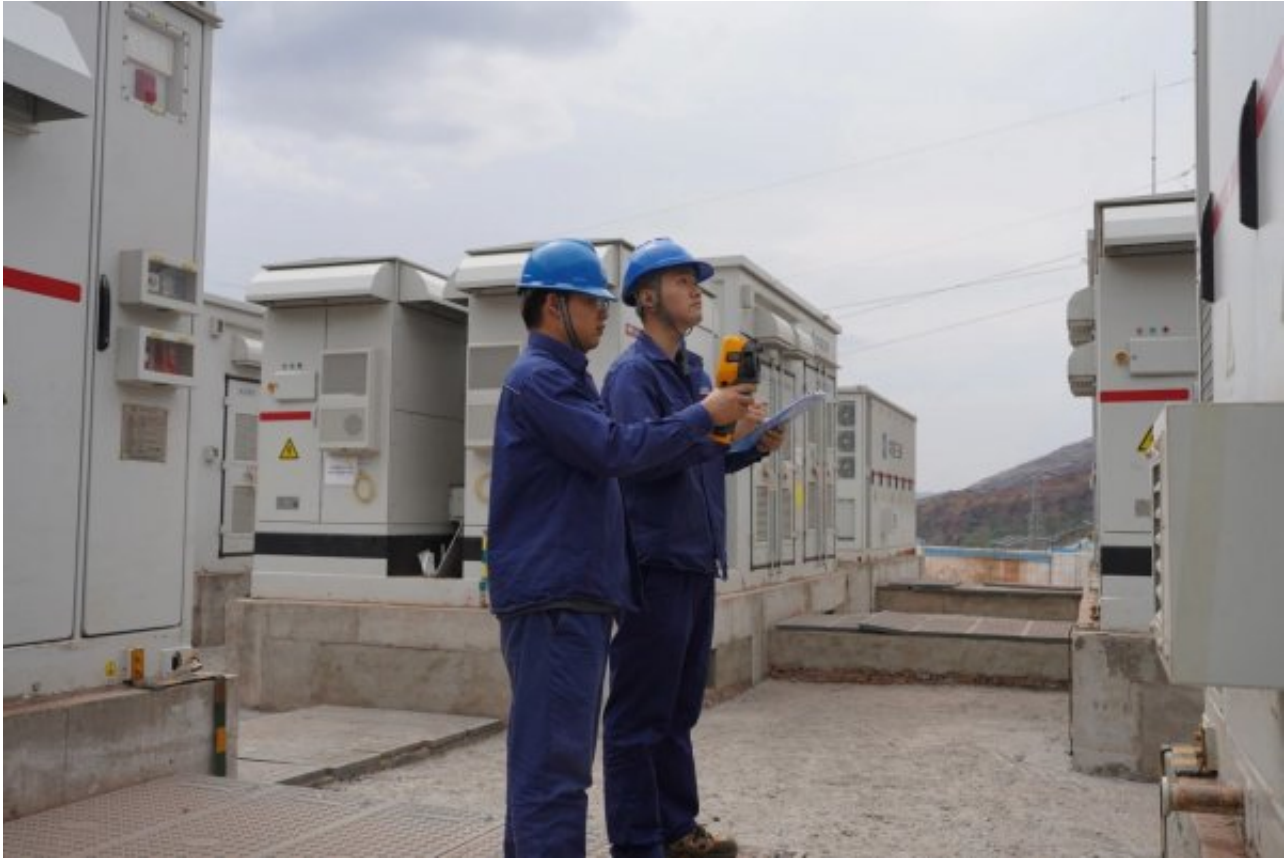
▲ 运维人员巡检监控电池舱温度
