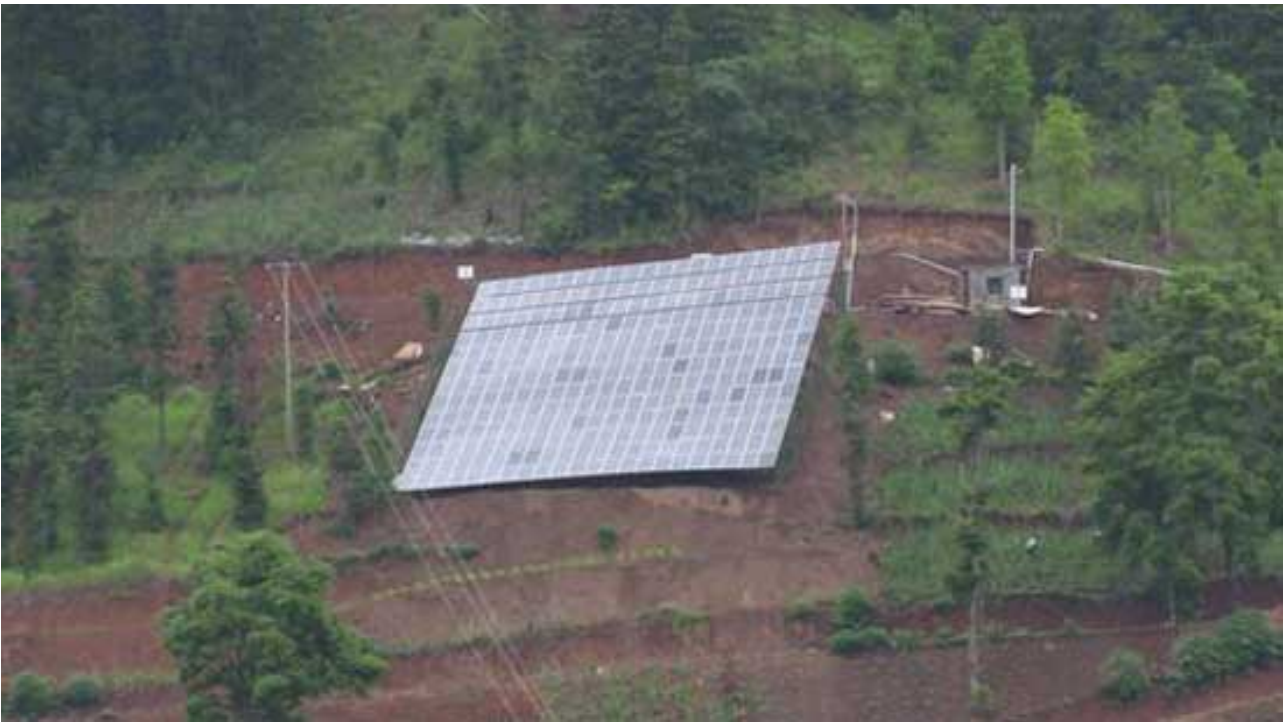
太阳能光伏提水系统农田作物灌溉
