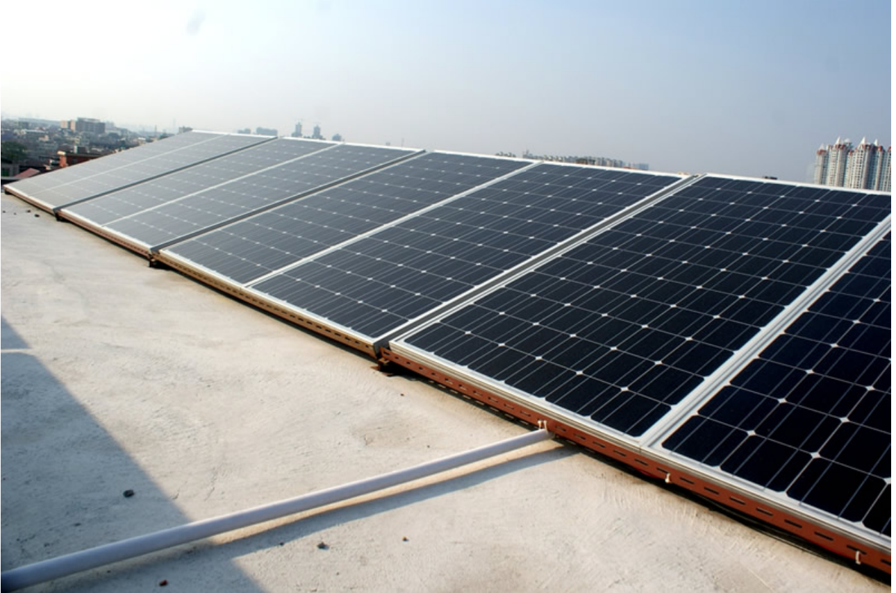
太阳能组件系统
