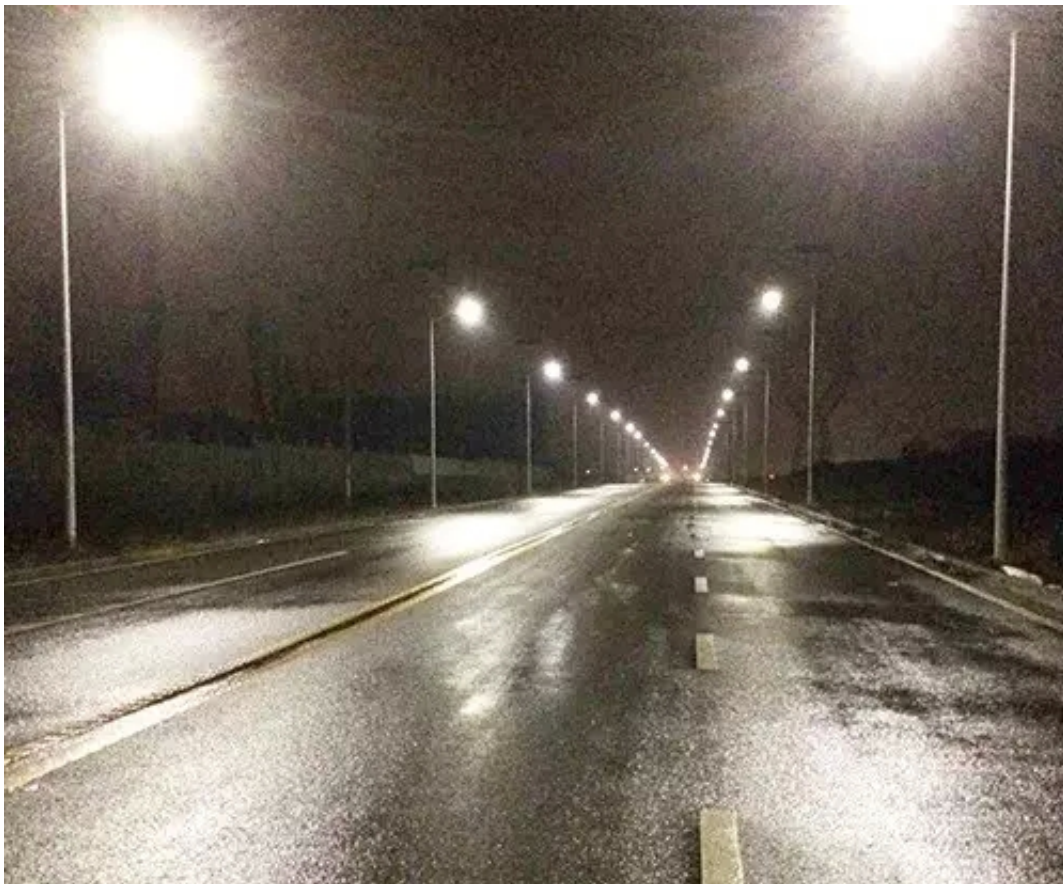
经开区东十二路第十五个阴雨天我司“全天候智能光伏道路照明系统”照明情况依然良好
