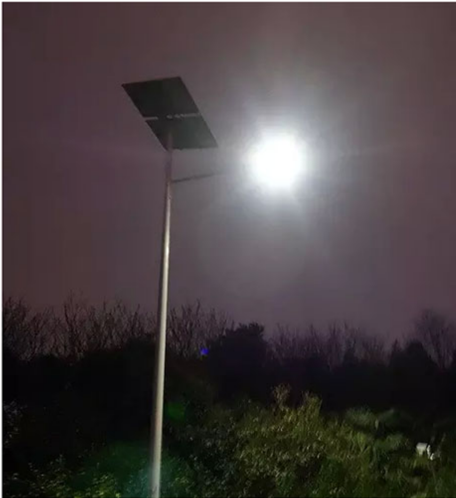
▲耐普恩“全天候智能光伏道路照明系统”阴雨天里的“光伏斗士”
