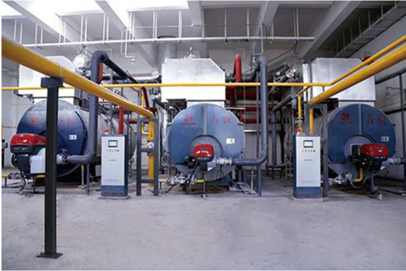
北京大兴真强物业新居里小区供热 FGR 一体冷凝热水锅炉 NOX 13ppm
