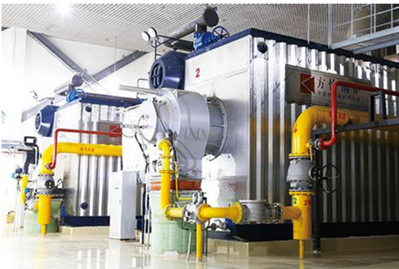
北京怀柔平安热力雁栖供热站 FGR 水管锅炉 NOX 24ppm
