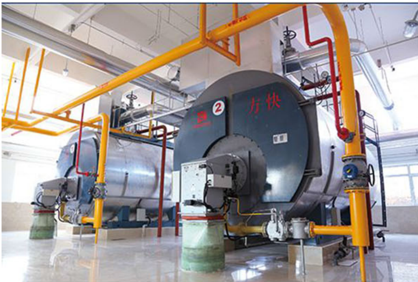
北京怀柔平安热力富乐园供热站 FGR 一体冷凝热水锅炉 NOX 20ppm
