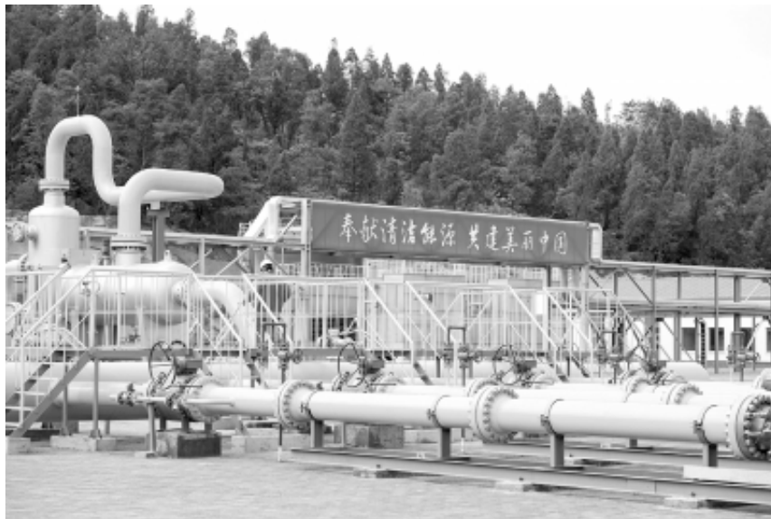
这是重庆涪陵白涛至石柱王场的大口径高压页岩气外输管道的重要节点——重庆页岩气涪陵增压站工艺装置区。新华社记者 刘潺 摄
