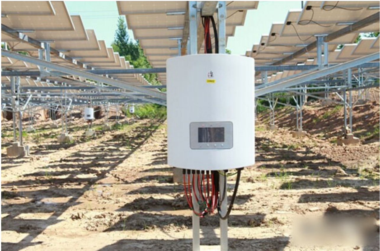
金寨6MWp农光互补智能光伏电站采用锦浪智能逆变器
