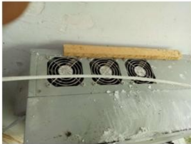
带风扇逆变器运行情况
