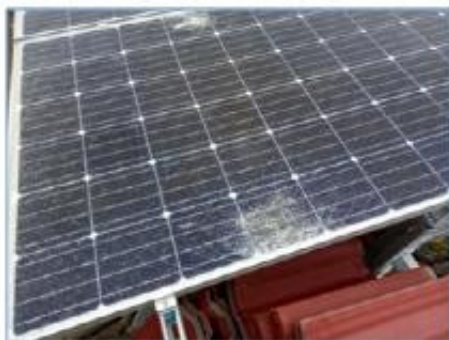
组串中有一块组件损坏
