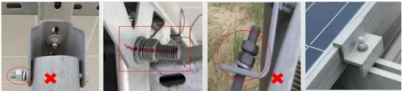
图9 螺栓紧固缺陷照片
