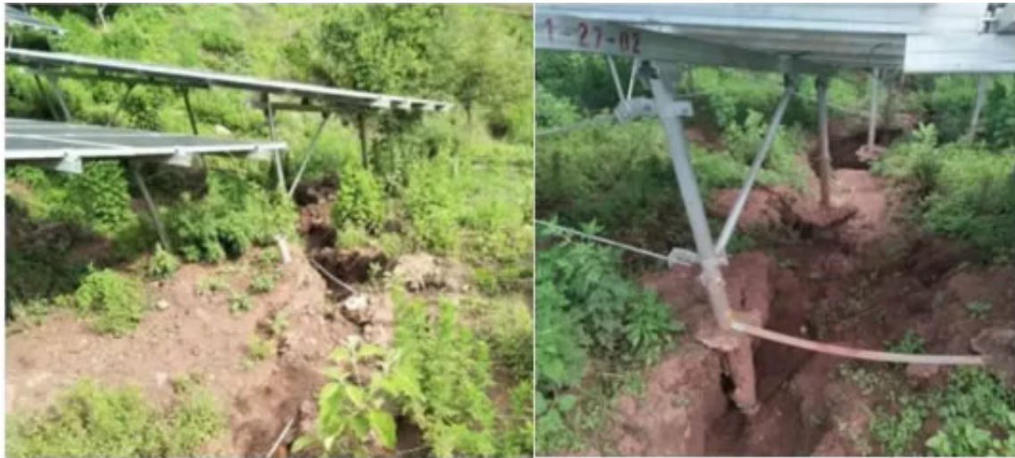
图 7 光伏区水土流失严重（存在滑坡风险）
