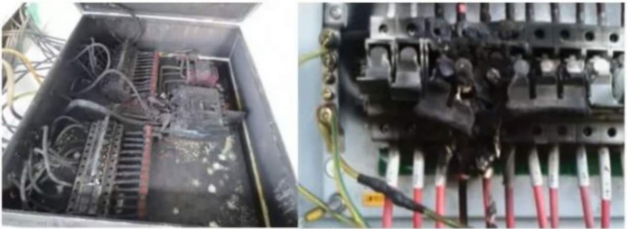
图 4 左) 汇流箱高压直流电弧引发燃烧右) 线缆虚接，熔断器和底座烧毁
