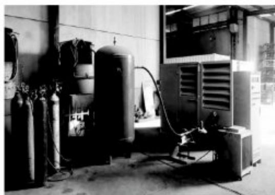
(a)发电机组系统现场图
