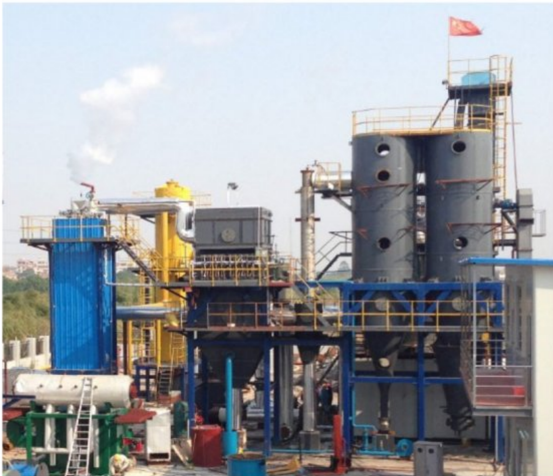
(b) 2 MW 内燃机发电及热气联供系统
