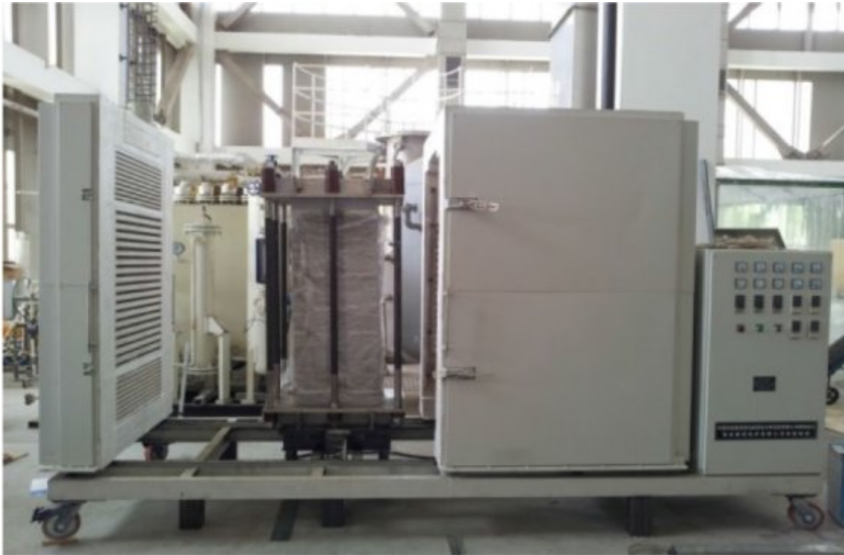
图 2 中国华能清能院开发的 5~10kW MCFC 发电系统
