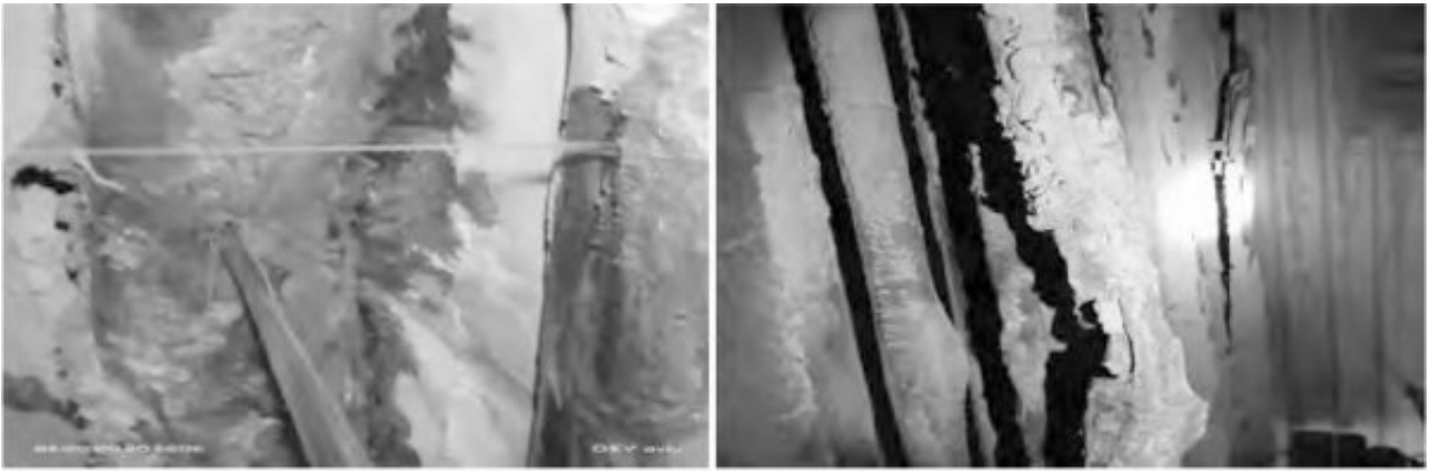
图2 三级过热器破损情况
