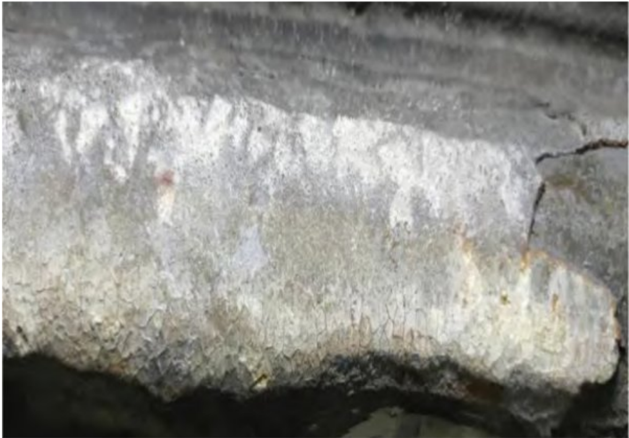
图1 向火面腐蚀产物
