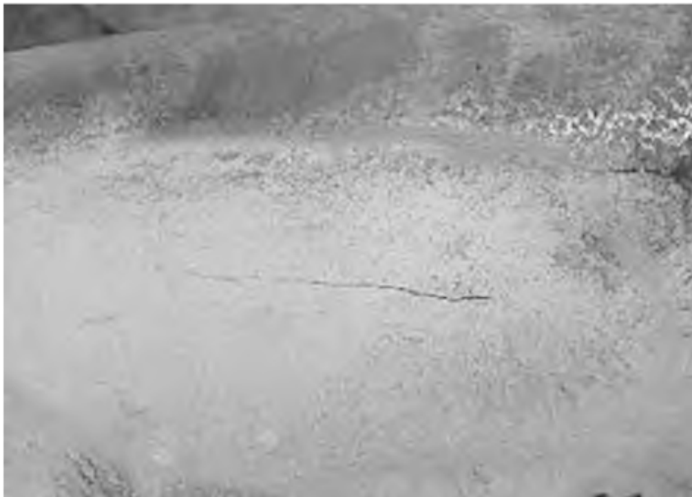
图 2 材料蠕变裂纹
