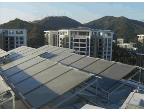
图13 屋面太阳能热水系统
