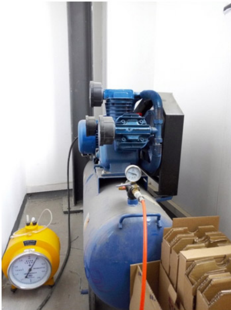
图2 化工未反应气循环气压缩机
